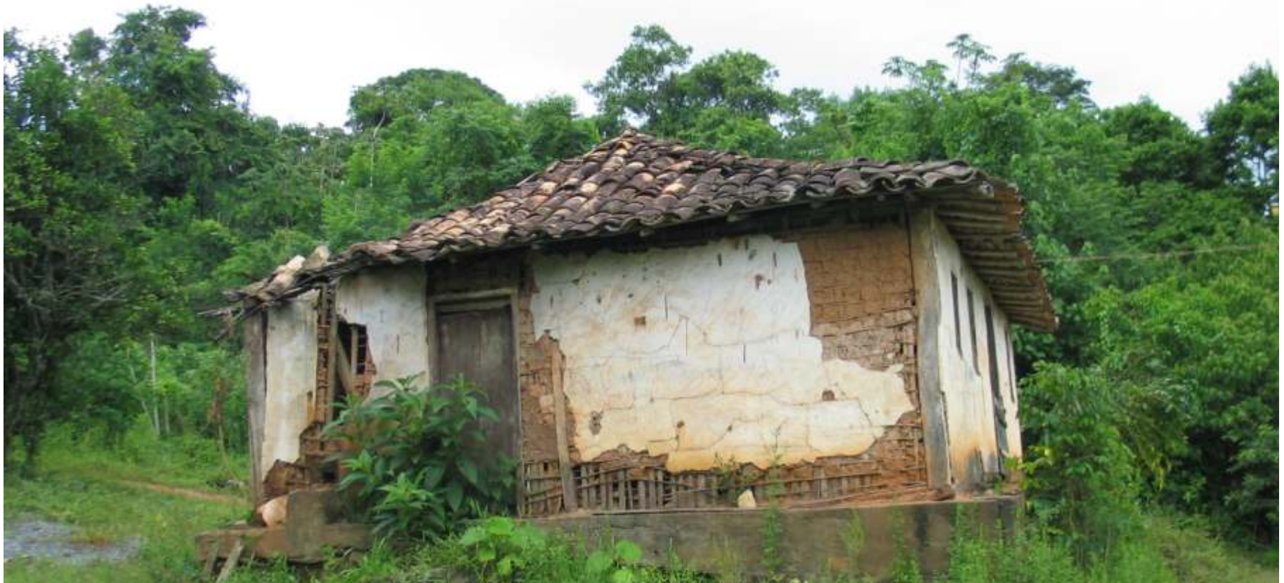
Quilombo João Surá, Núcleo Guaracuí, Município de Adrianópolis. Casa de pau-a-pique cujo desgaste do reboco permite a observação dos materiais que compõem a parede.
